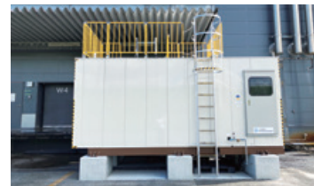
今後増設予定のバイオ式生ごみ処理機
